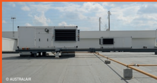
Les deux rooftops adiabatiques mis en place en toiture.
